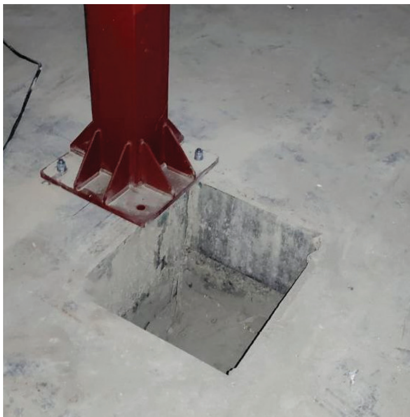
Рис. 4. Выявленное непроектное положение приемка вблизи установки колонны в осях А — А/1 и 47–48
